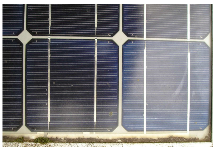
Figura 3. Detalhe mostrando o acúmulo de sujeira na borda inferior de um dos módulos analisados.
