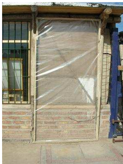
Figura 4: Muro norte de quincha con el sistema de muro acumulador adosado sin cambio de color
