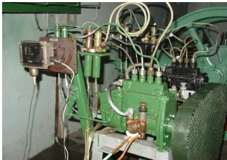
Figura 2. Instalación experimental (Banco de prueba.)
