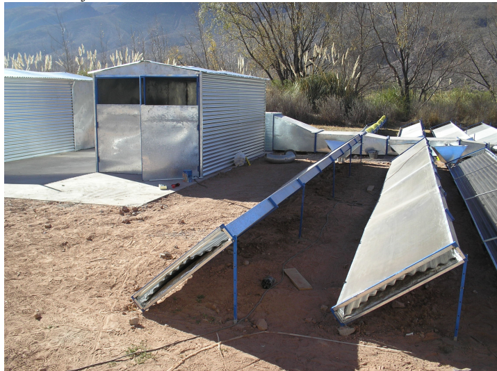
Figura 4: Colectores y cámara de secado
