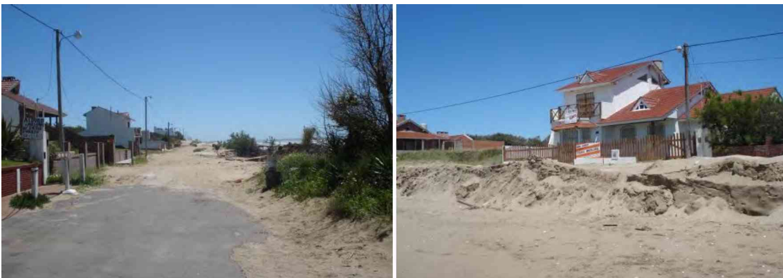
FOTOGRAFÍA N°17: COSTANERA DE LAS TONINAS DESTRUIDA POR EL MAR Y FOTOGRAFÍA N°18: VIVIENDA FRENTISTA CON SIGNOS DE EROSIÓN EN LA VEREDA. Fuente: Fotografía propia, noviembre de 2010
