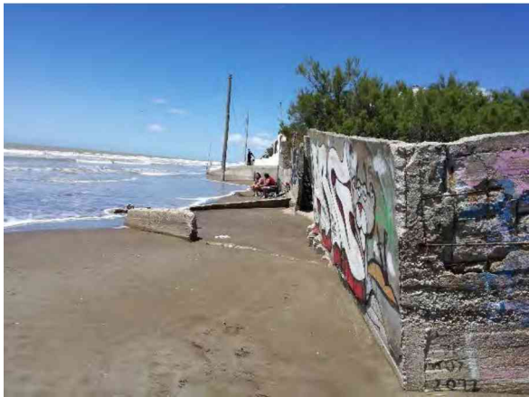
Foto 27. Costa. Grado de riesgo muy alto. Mar del Tuyú. La Costa. 11/2018. Fuente propia
