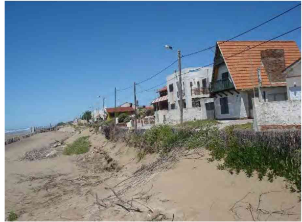
Foto 21. Costa. Grado de riesgo muy alto. Las Toninas. La Costa. 11/2010. Fuente propia
