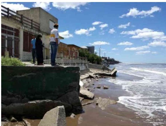
Foto 23. Costa. Grado de riesgo muy alto. Mar del Tuyú. La Costa. 11/2018. Fuente propia
