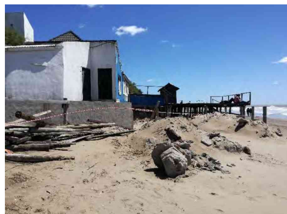
Foto 24. Costa. Grado de riesgo muy alto. Mar del Tuyú. La Costa. 11/2018. Fuente propia
