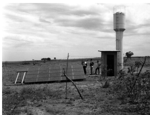
Figura 2. Sistema de bombeamento fotovoltaico em poço tubular.
