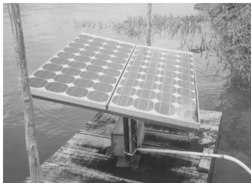
Figura 3. Sistema de bombeamento fotovoltaico de superfície instalado
