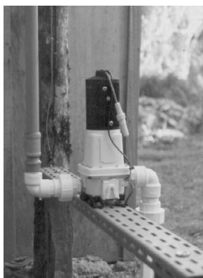
Figura 1. Sistema de bombeamento fotovoltaico de superfície.
