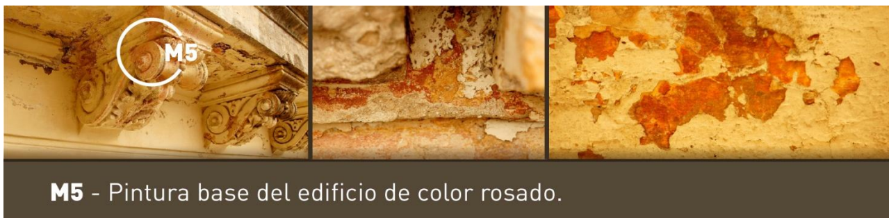
Figura 7 - Pintura original frente del edificio
