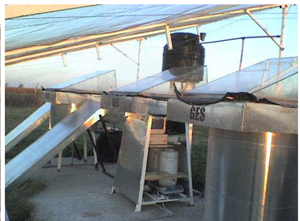
Figura 5. Vista de la instalación completa.
