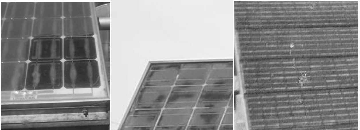
Figura 1: Módulos deteriorados de diferentes marcas y modelos, luego de al menos doce años de instalados
