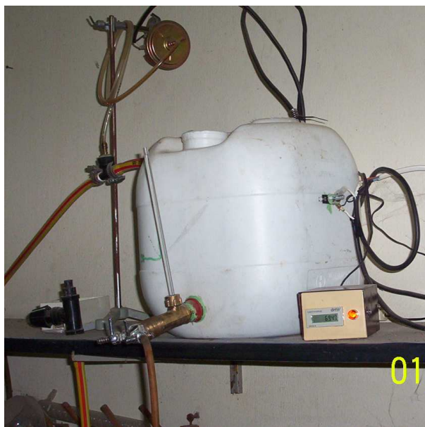
Foto N° 1 – Instalación de calentamiento de agua para calefacción.
