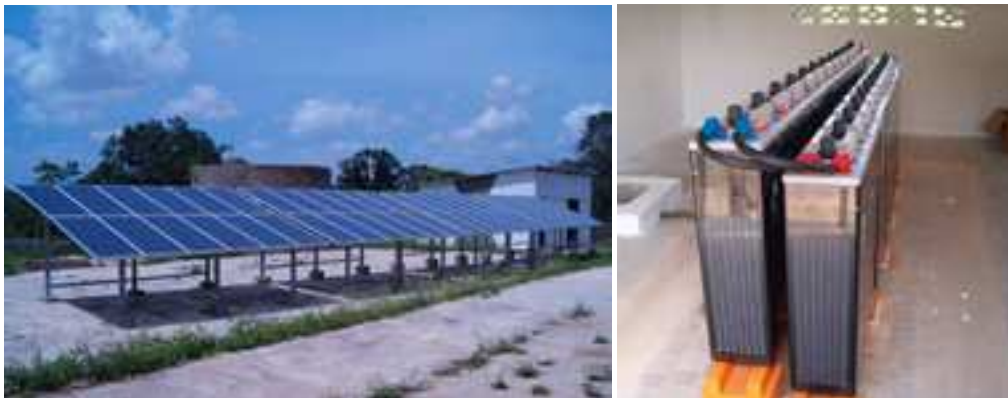
Figura 1: Generador fotovoltaico y banco de baterías de la comunidad rural El Triunfo.
