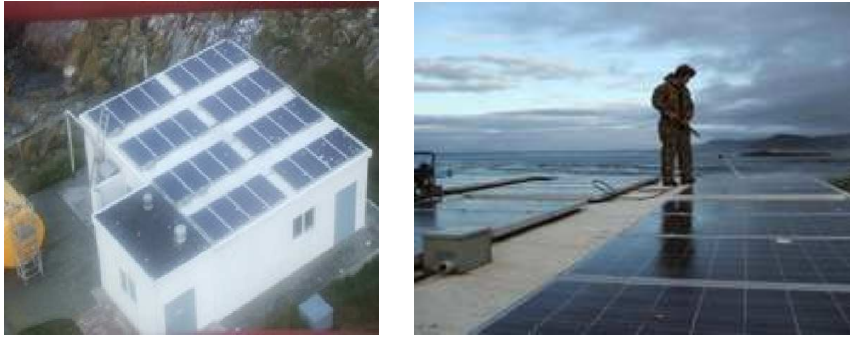
Figura 3: Paneles solares ubicados sobre la sala de máquina y eliminación del guano de gaviotas.
