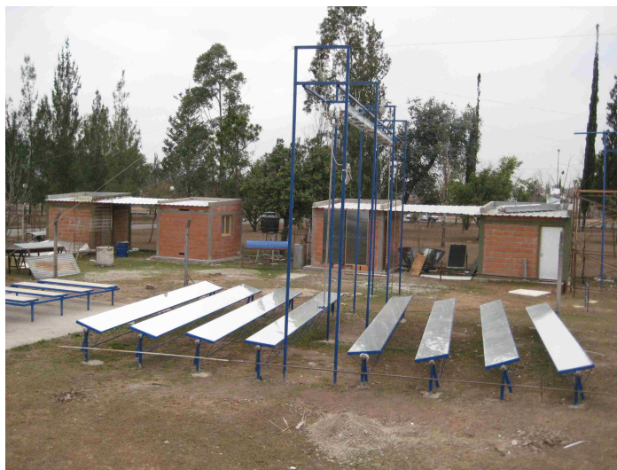
Fig. 1.- Vista general del concentrador Fresnel Lineal de 24 m2
