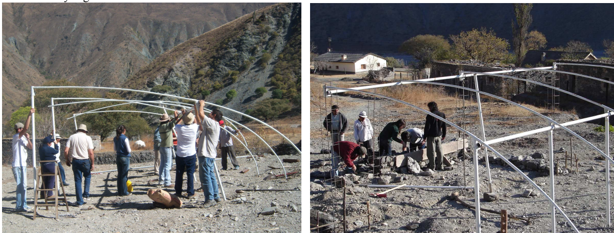
Figura 5 y 6 montaje de estructura construcción de cimientos, con participación de alumnos docentes y comunidad
