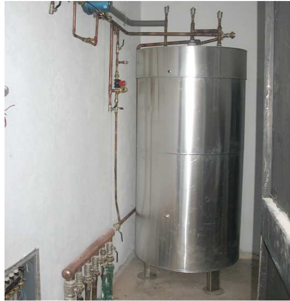
Figura 2: tanque acumulador en sala de máquinas durante la obra.
