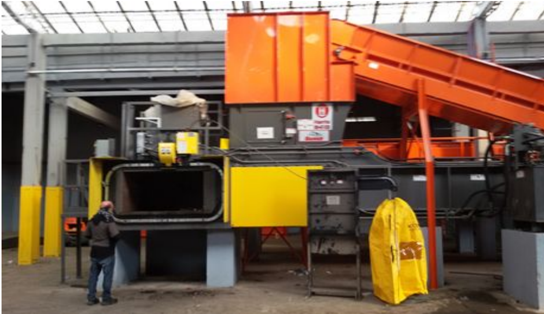
Equipamiento de la planta de tratamiento. Albrieu, C. 10 de diciembre de 2019.
