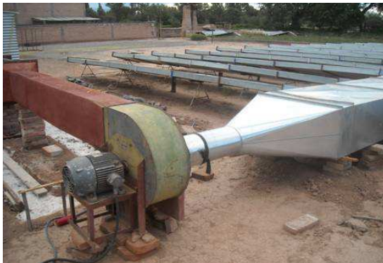
Figura 2: Ventilador y acople del caño maestro
