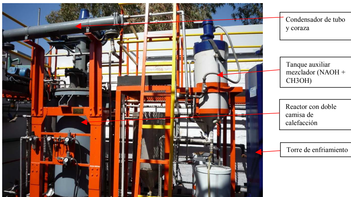
Fig 1: Reactor de transesterificación y accesorios asociados a la planta piloto
