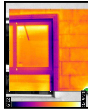
Figura 12: Detalle de las pérdidas por carpintería
