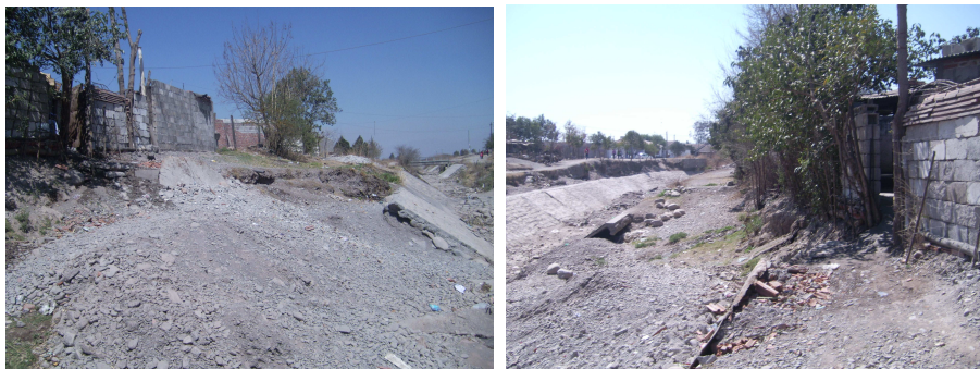
Fotografía 3 y 4: Viviendas que sufrieron inundación en Barrio Los Lapachos, aún en situación de riesgo.
