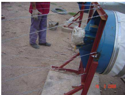
Figura 4: Detalle de los ventiladores
