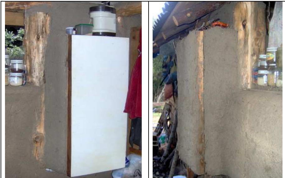
Figura 2a): Cerramientos laterales y sellado de filtraciones realizados en barro.
