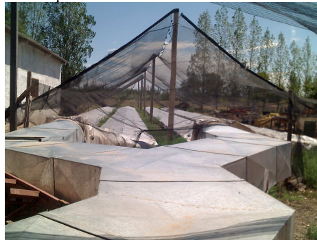
Figura 1: Vista frontal de Colectores solares y Pantalón realizado en Chapa galvanizada, y con la protección antigranizo de los colectores
