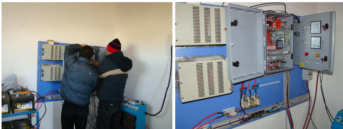
Figura 11 – (izq) I. Lescano y R.Oliva en el montaje del SISMED/C en el tablero de Glencross, 24/5/2010 y (der) SISMED/C operando en conjunto con el resto del sistema 24-5-2010
