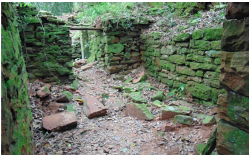
Figura III. Vista interna de una de las habitaciones de otro de los edificios que aún se mantiene en pie.
