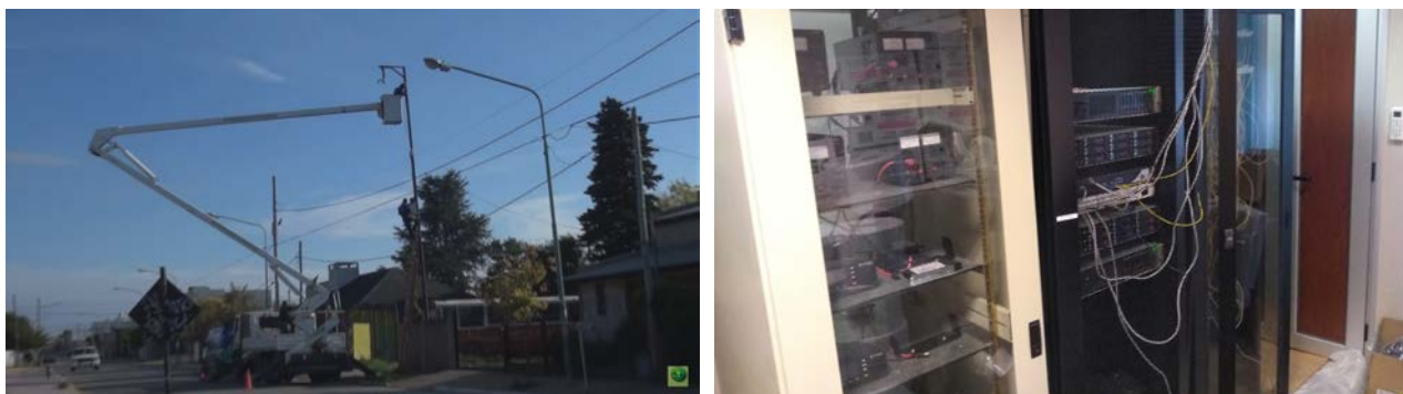
Fuente: “Cámaras de seguridad” (Prensa Ensenada, 14 - 1 - 2019, izquierda) y Cuarto de servidores (Foto personal, derecha).
