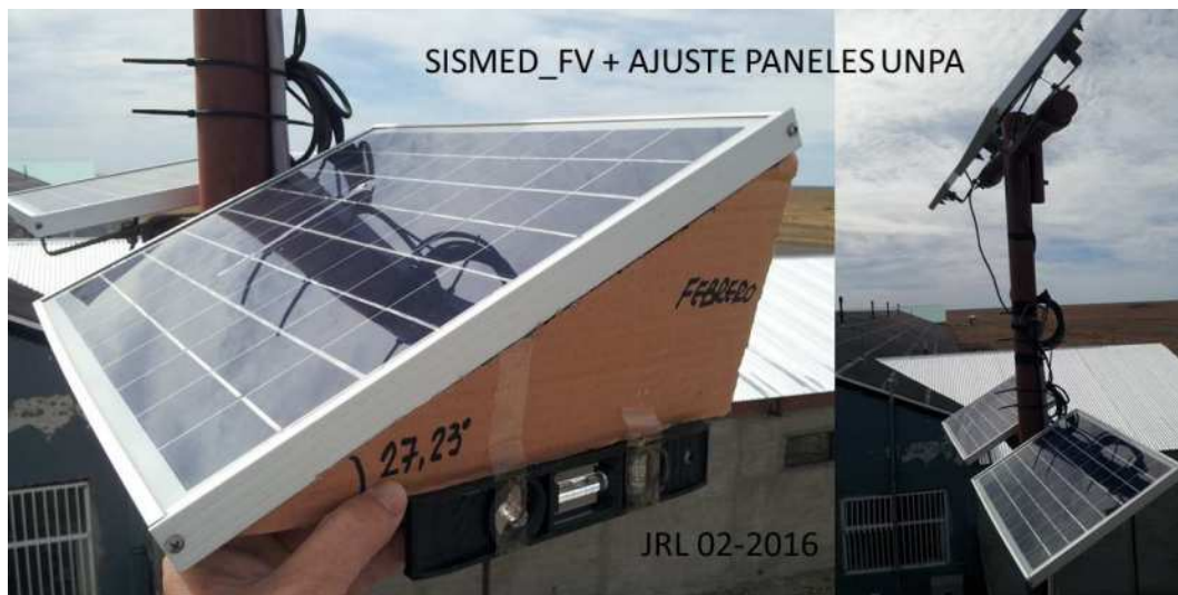
Figura 11- Paneles FV y sistema asociado en AEA/UNPA (Foto – 02-2016)
