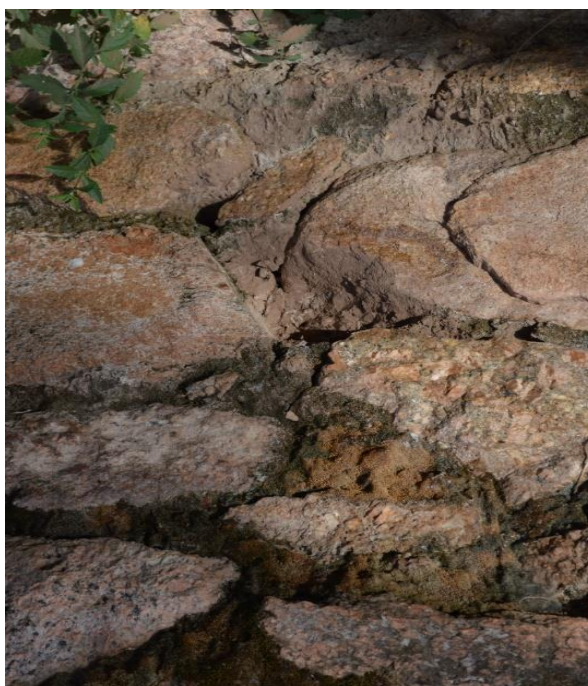
Figura 6.5. Detalle del mortero de unión contenido entre los bloques líticos del muro divisorio (Foto: Capparelli A.)
