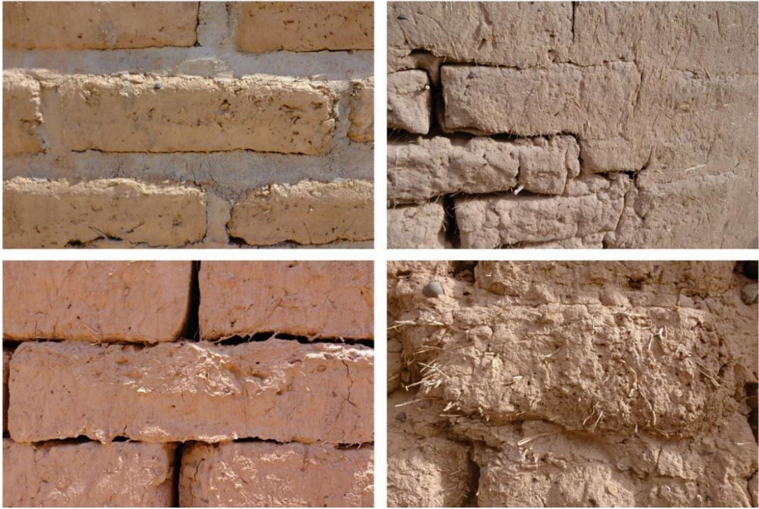
Figura 9.2. Detalle de adobes en que se observan contenidos de fibras en distintas proporciones (Fotos: Capparelli A.).
