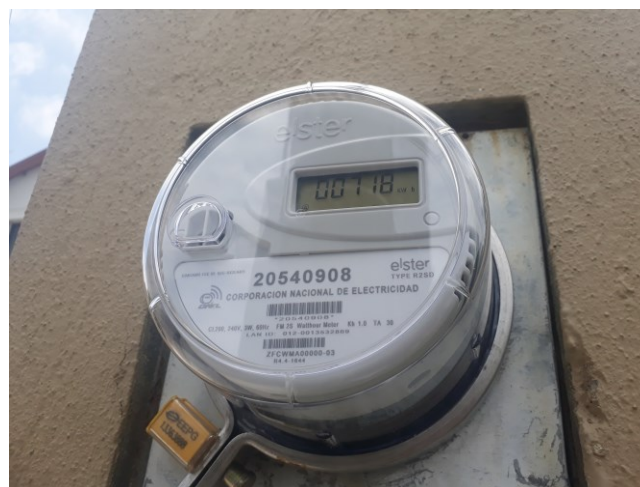
Figura 67. Lectura del medidor, inicio del monitoreo térmico
