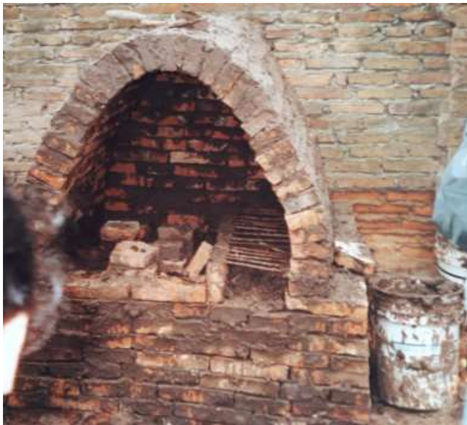
[Figura 102] Proceso de construcción de horno de leña en la casa del cacique Aniceto en la comunidad Toba.
