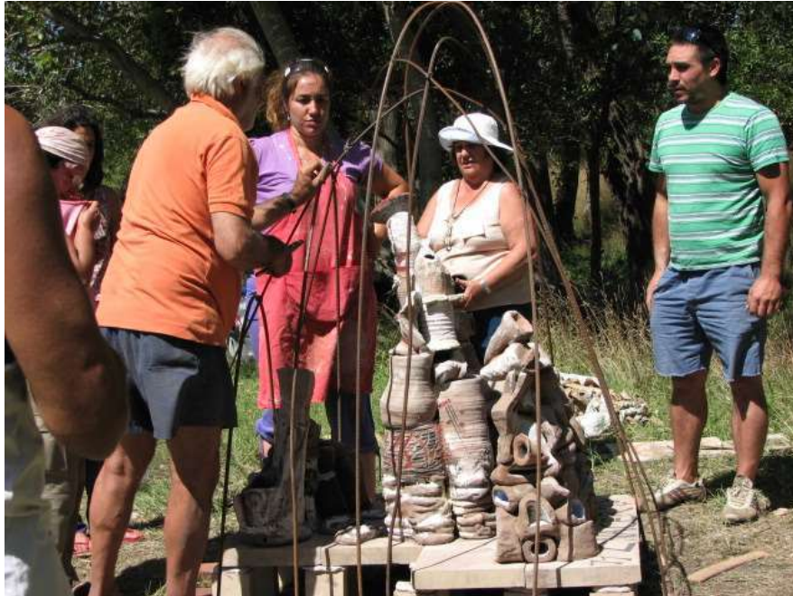
[Figura 68] T. Corte junto a los encuentristas revisan las varillas de hierro de la estructura metálica para formar el horno.
