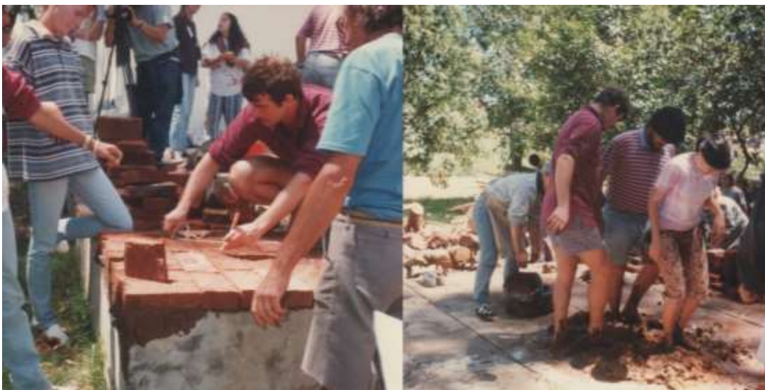
[Figuras 27 (Izq.)] Los autores preparan la base midiendo el diámetro mayor. [Figura 28 (Der.)] Preparación colectiva de la mezcla del pastón.
