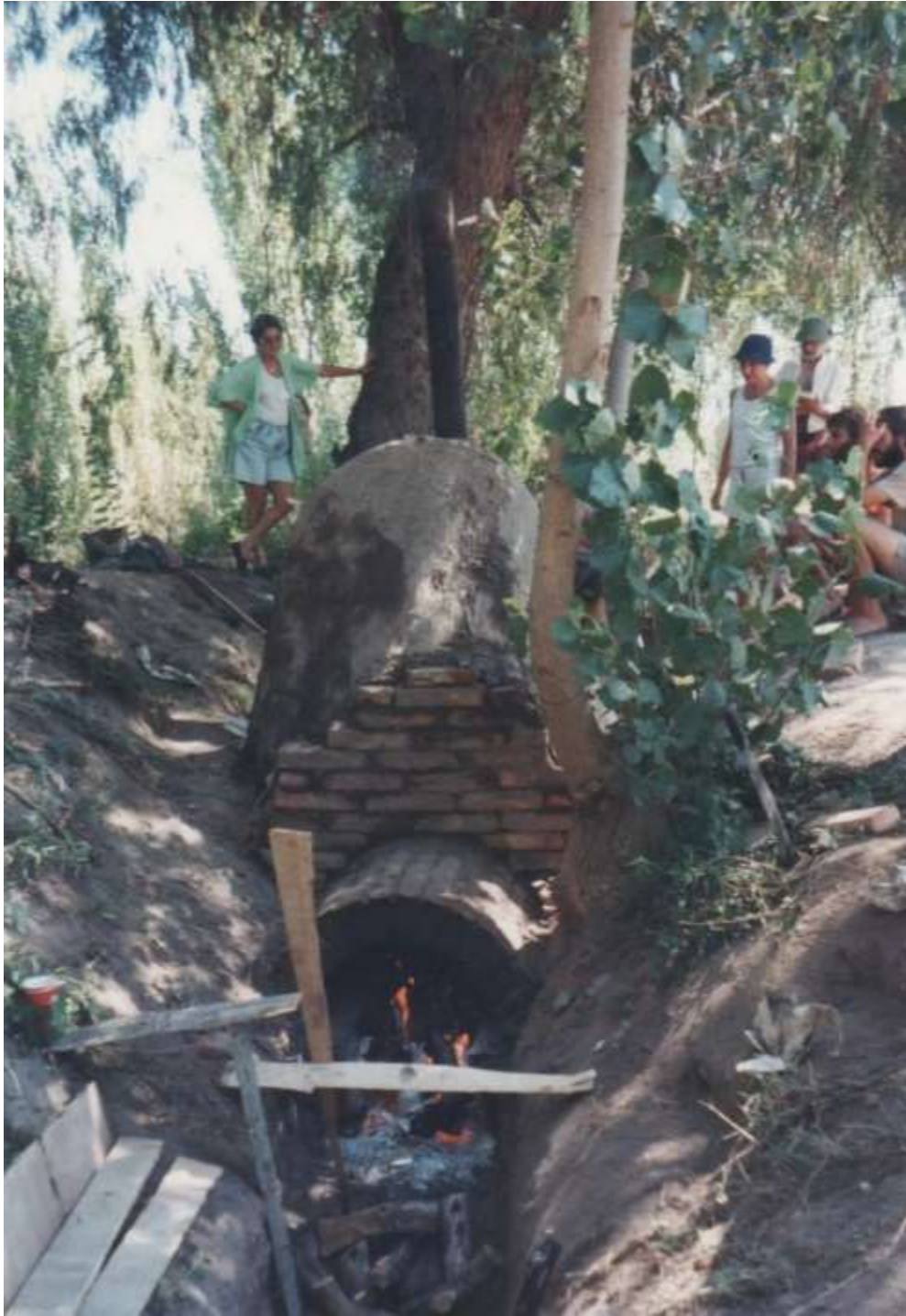
[Figura 108] Vista frontal de la boca de carga del horno construido en la acequia seca que bordea el Regimiento.
