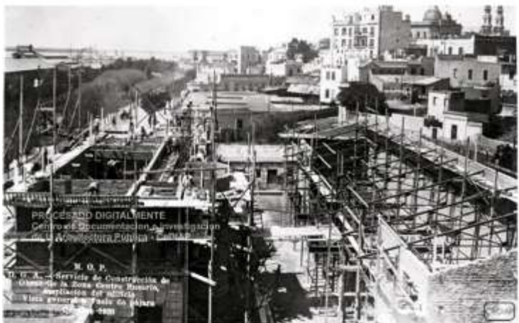
Foto obras de ampliación de las oficinas de la DGA MOP en Rosario (1928). Fuente: CEDIAP.
