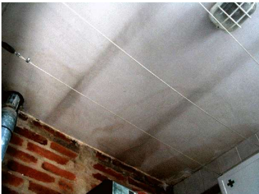
Figura 5.3: Ejemplos de condensación superficial una losa de bovedillas de EPS y perfiles de acero. Fuente: propia
