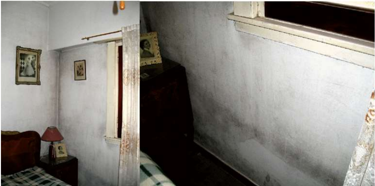
Figura 5.4: Ejemplos de condensación superficial en aristas, rincones, detrás de cortinas. Fuente: propia
