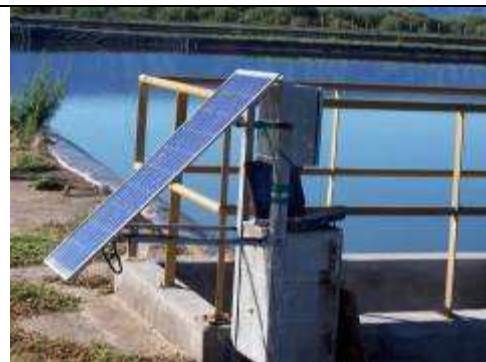
Figura 2: Sistema de Medición alimentado por panel fotovoltaico: ubicación en cámara reguladora de niveles del módulos N° 3 de la planta de tratamiento de efluentes.
