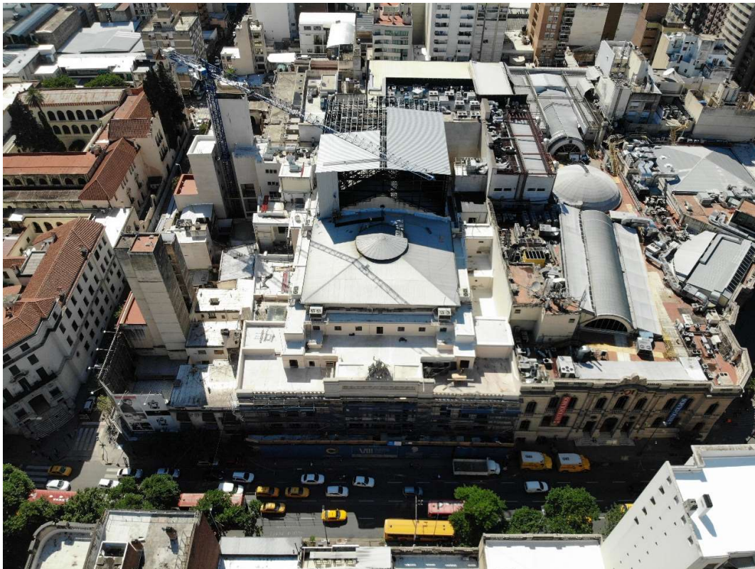
Figura N° 4. Imagen de dron tomada durante la intervención como parte del registro de obra. Puede verse sobre la caja escénica la grúa instalada para la puesta en obra de los materiales. En primer plano también se puede ver la fachada completamente cubierta por los andamios.
