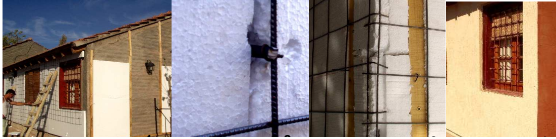
Figura 7: colocación de la aislación térmica: 1- unión al muro a) con alfajías de álamo y b) con malla SIMA; 2- detalle de colocación con malla cima 4.2 mm; 3- detalle de la esquina; 4- muro terminado c/revestimiento plástico.
