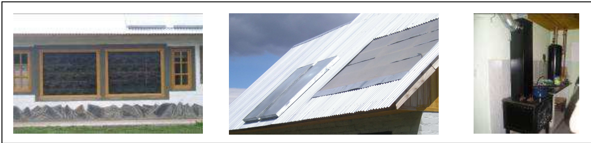
Fotos 4, 5 y 6: Muros colectores-acumuladores; Colectores para calentamiento de agua, Cubiertas de la Vivienda y del Invernáculo; Cocina de chapa y termotanque, ambos a leña y de alta eficiencia.
