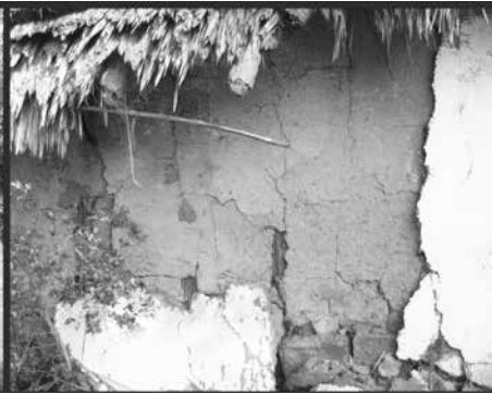
3-B. Pared oeste de la Habitación 1, en donde se evidencia el mal estado de conservación de esta estructura. Foto: M. S. García Lerena.
