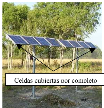
Figura 9.- Vista del banco de 400 Wp.
