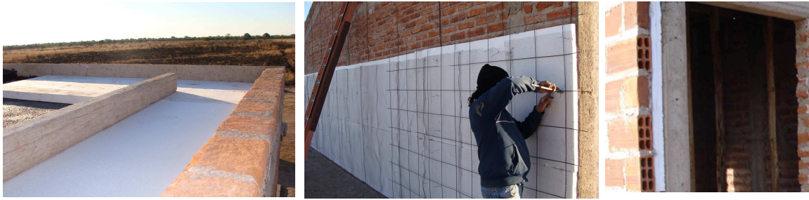
Figura 3: Aislamiento térmico en envolvente. Protección mecánica sobre aislamiento térmico en pared este: revoque sobre metal desplegado que no fue la especificada por los proyectistas en el pliego de licitación (centro), y en pared oeste, con ladrillo cerámico (derecha).
